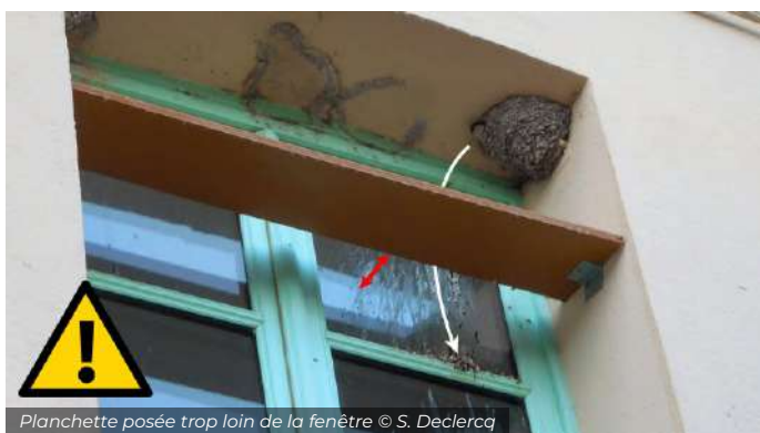
Planchette posée trop loin de la fenêtre © S. Declercq
